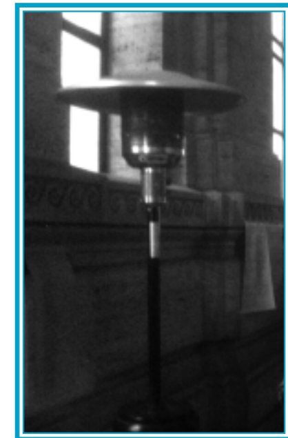
Una delle stufe installate presso i seggi del Tribunale di Roma
