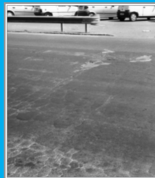
Buche e asfalto rovinato, strisce cancellate, «protezioni» pericolose, parcheggio maltenuto. Brutto ma frequente scorcio delle strade romane Foto di Simona Foschi
